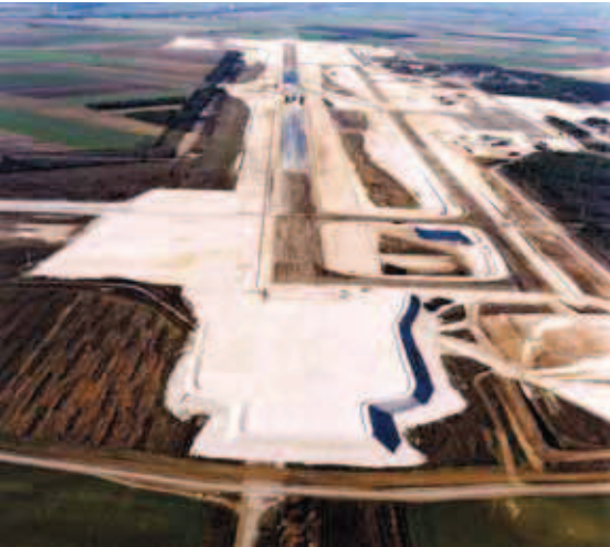
Europort de Châlons-Vatry : vue aérienne des terrassements généraux de l'aéroport de fret, 1999. ©DGAC/STAC/Michel Jolyot
