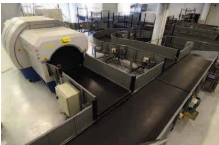
Dispositif de tri et de contrôle des bagages de soute à Toulouse-Blagnac, 2005. ©DGAC/STAC/Gabrielle Voinot
