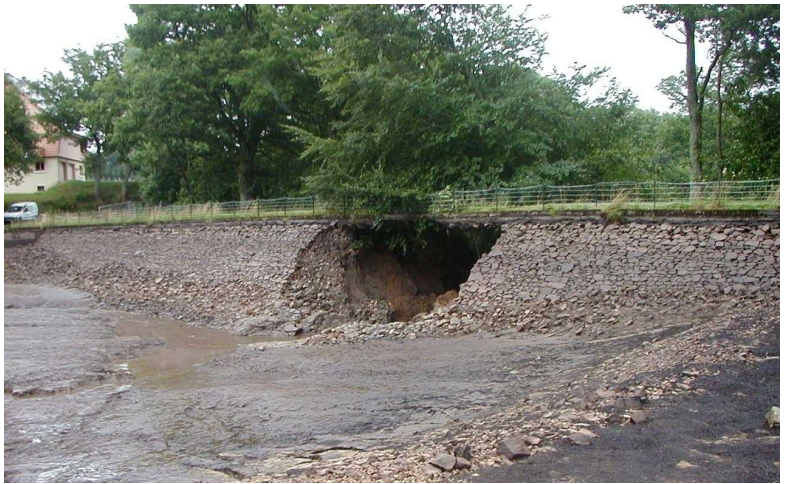
Rupture du barrage des Houches - Photo Cemagref
