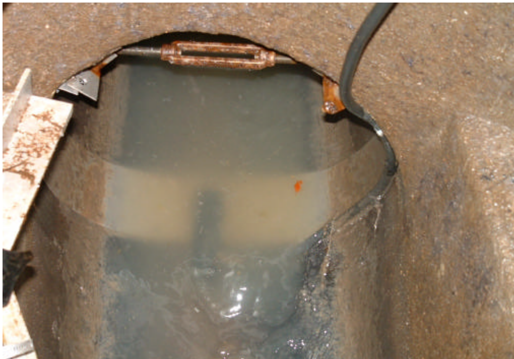
Figure 5 : Fixation du capteur de débitmétrie dans le collecteur.
