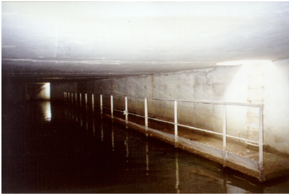
Figure 41 : St Joseph de Porterie : chambre à sable
