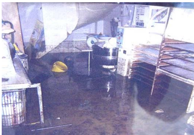
Figure 25 : installations en sous-sol d'un boulanger pâtissier sinistré
