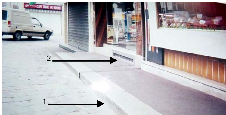
(1) Surélévation du trottoir du pas de porte de deux boutiques. (2) Colmatage partiel de la fenêtre d'aération du sous-sol de l'une d'elles.
