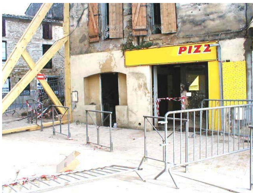
Photo prise le 09/09/2002 suite à la crue de la Vidourle. Cliché Paysserand.
