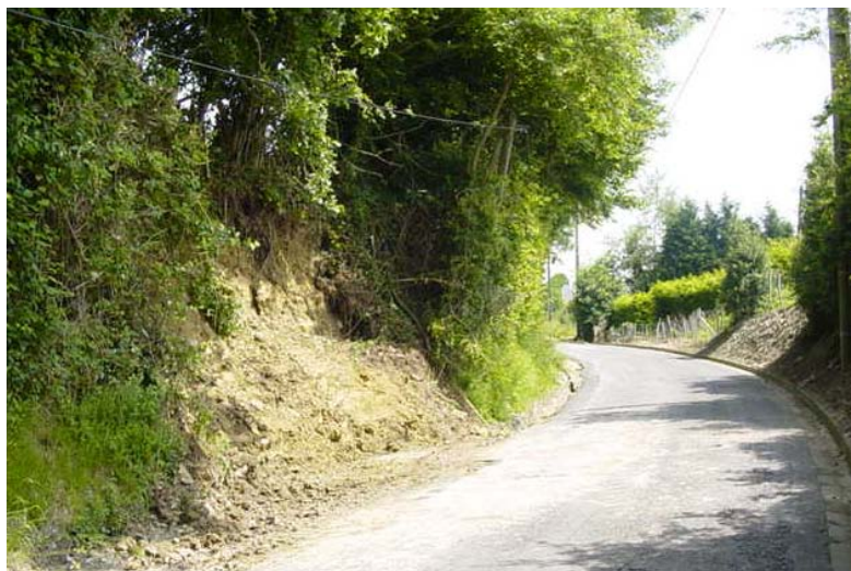
Figure 27 : petit glissement de terrain survenu sur un chemin communal. Villerville.
