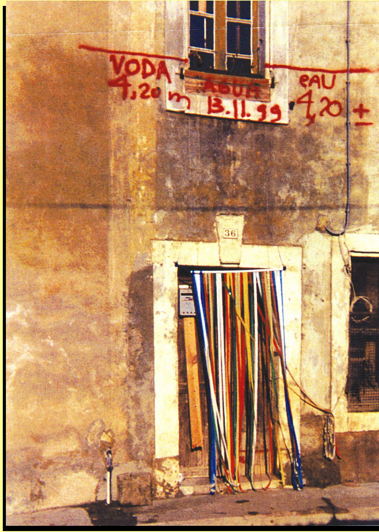
Façade avec repère de crue, rue des Hortes, Sallèles-d'Aude.
