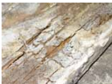
Figure 2 : Mэрule et pourriture cubique.
