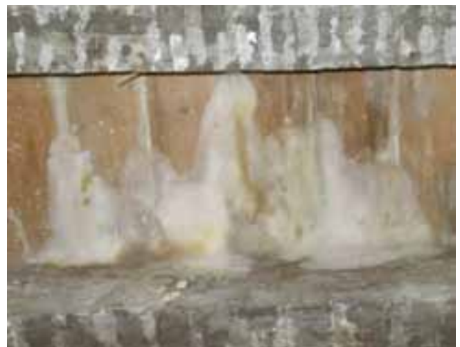
Figure 3 : Contamination sur chêne (plancher vue de dessous). Ancien couvent des Ursulines, XVII e siècle. Ancenis (Loire-Atlantique).
