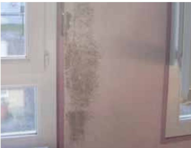
Figure 2 : Contamination sur toile de verre (salle de classe – école).
