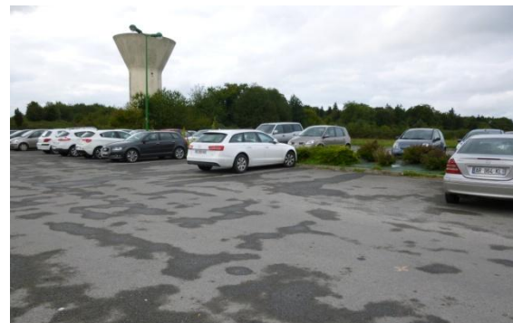
Figure 21 : revêtement d'une aire de Covoiturage en Ille et Vilaine (InterosteP, Fougères, oct. 2013)
