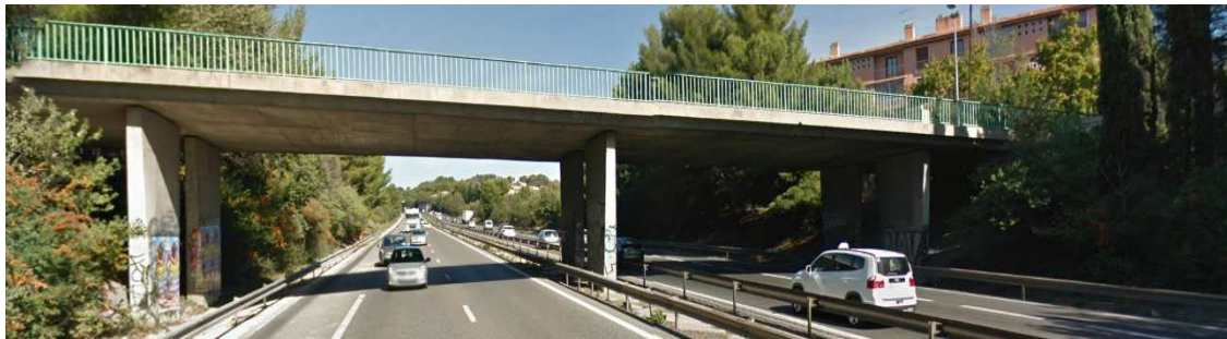
Figure 23 : Ouvrage courant étudié, datant de la fin des années 1960, conçu sans disposition particulière vis-à-vis du séisme, et situé dans une zone dont l'aléa sismique a été récemment réévalué.
