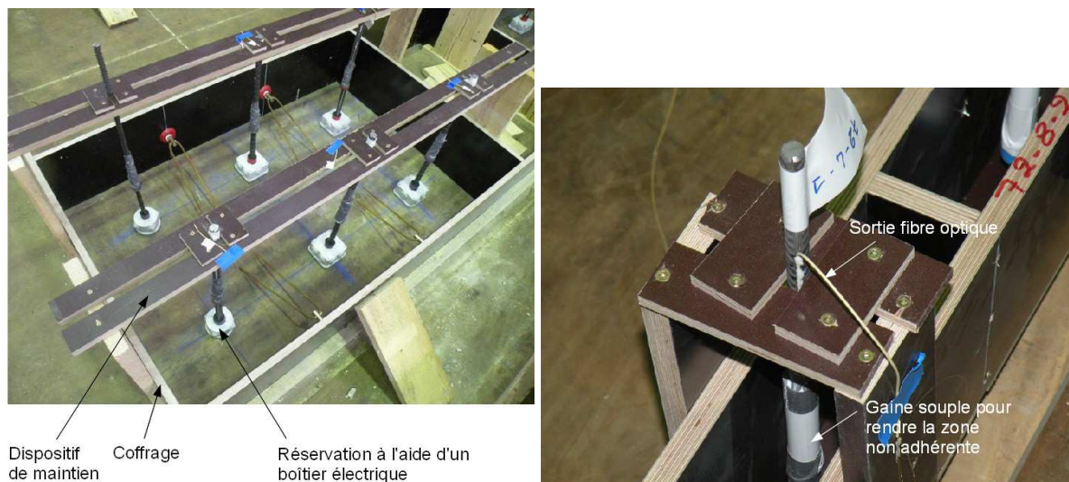
Figure 4 : Préparation des coffrages et des armatures avant coulage des corps d’épreuve « massifs » (à gauche) et « plaques minces » (à droite)
