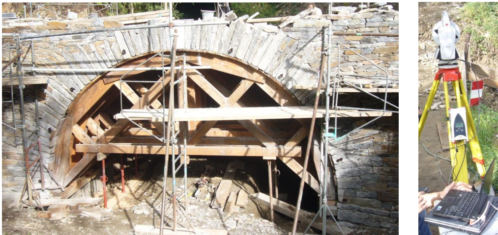
Figure 3.7 : Position des réflecteurs sur l'ouvrage (à gauche) et appareil AT401 de mesure des déplacements par laser (à droite)
