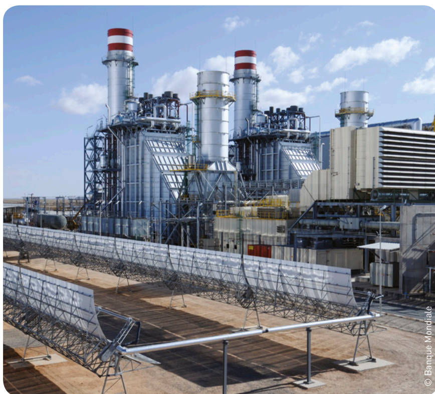
Centrale électrique thermo-solaire à Ain Beni Mathar, Maroc
