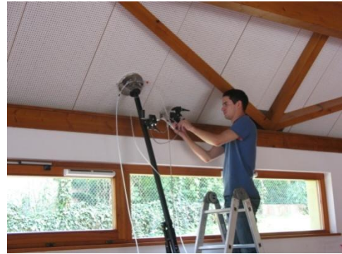
FIGURE 27: Mesure du taux d'émission au plafond.
