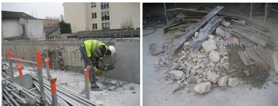
Figure 1 - Reprise d'un ouvrage et déchets associés
