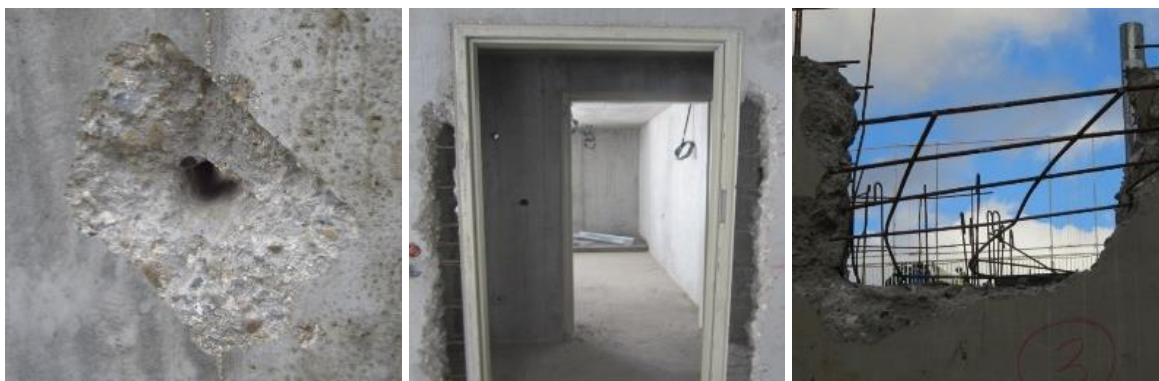
Figure 2 - Exemples de défaut : éclat, porte mal implantée, réservation de poutre manquante
