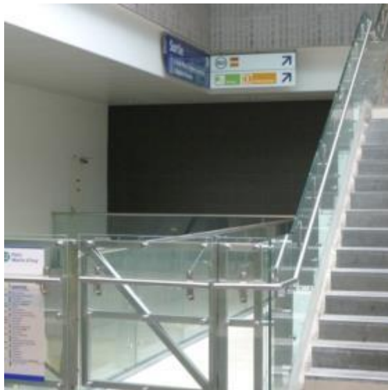
Photo 16 : Panneaux sortie et informations difficilement accessibles
