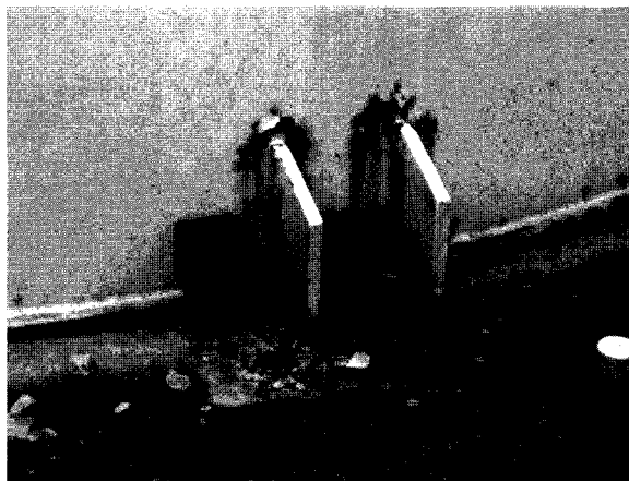
Figure 2.15 : La cause principale du glissement est la corrosion des ancrages.
