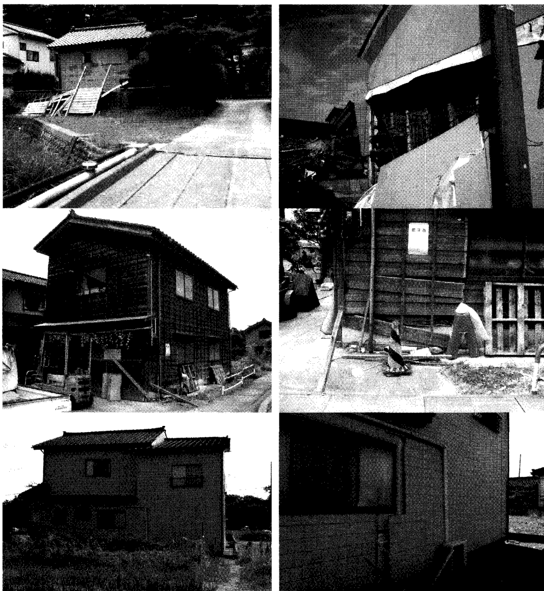
Figures 3.17 : Dommages aux parements en bois des façades
