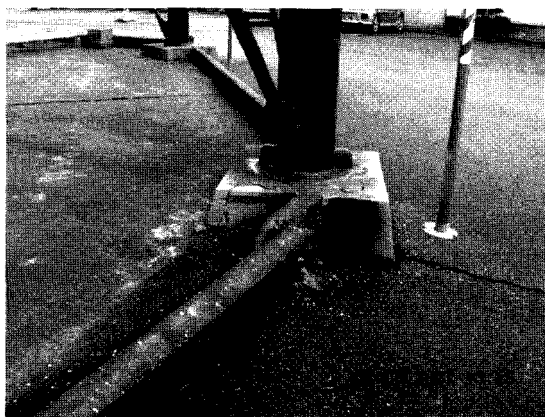
Figure 2.30 : Zone gare Rupture de bordure. Perte de l'enduit sur le socle
