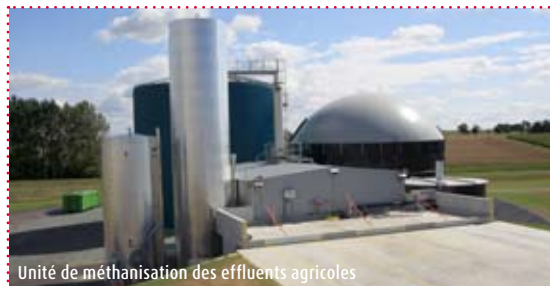
Unité de méthanisation des effluents agricoles
