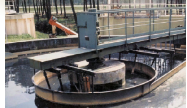
Station d'épuration Photo : G. Crossay
