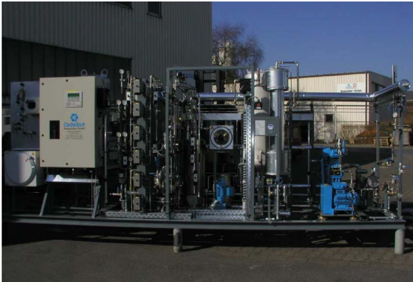
Centre de Braunschweig – Petite unité de production de 2 Nm 3 /h biogaz permettant la production de 2 Nm 3 /h de gaz Pureté : 99, 999 vol. % H 2 .
