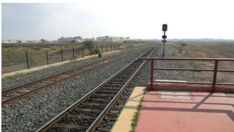
Figure 126 Signal de BAL en sortie d'évitement
