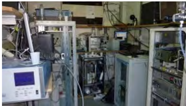
Figure III.1.3 : Instruments installés dans l'abri terrasse pendant FRANCIPOL
